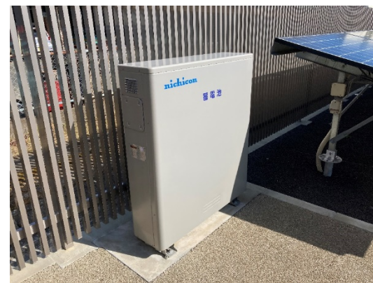
蓄電池設置状況 (5.9kW)
