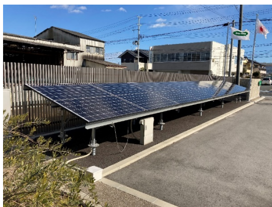
PV設置状況 (5.4 k W)
